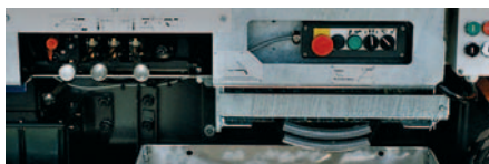
Commande intérieur et extérieur
